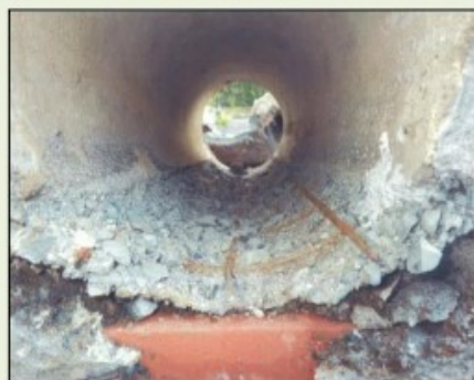
損傷した下水道管
