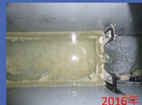
中和処理装置内の写真
